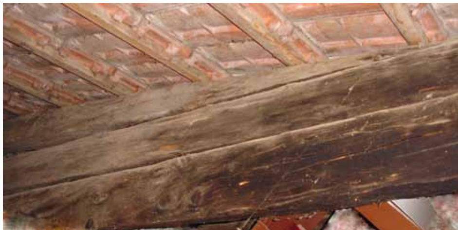
Aufgeblattete Holzbalken in alten Dachkonstruktionen.
